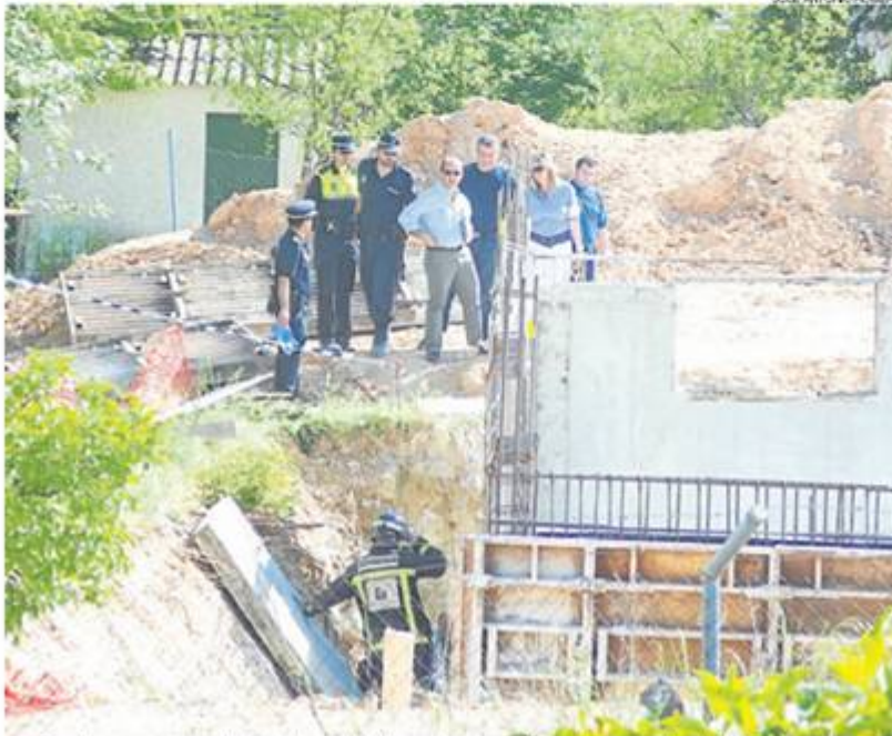
Bomberos, policías y trabajadores de Cabra observan el lugar de un accidente laboral mortal.
